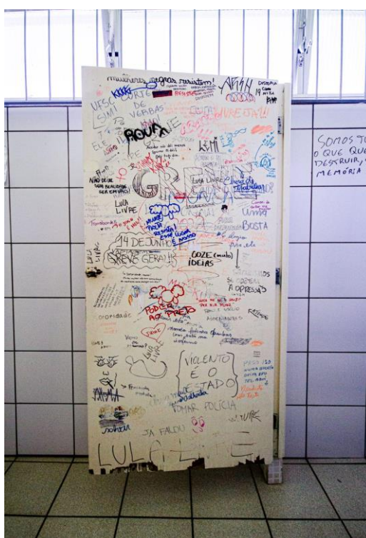
Figura 1 – fotografia do banheiro feminino do CCE da UFSC (jan. 2023)
