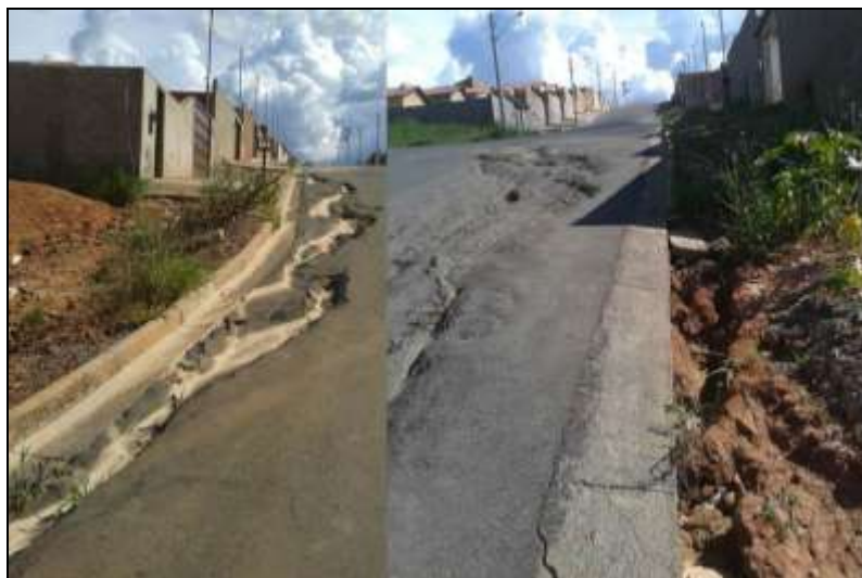
Figura 15 – Conjunto habitacional popular com sulcos nas ruas (A) e calçadas (B) devido a ineficiência do sistema de drenagem pluvial.
