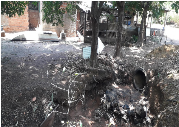
Figura 15: Erosão e alagamento
