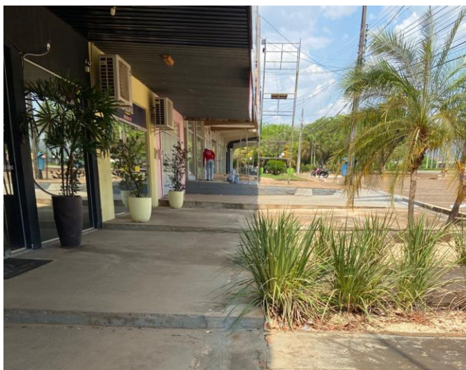
Figura 1 - Calçadas fragmentadas e com desníveis pouco acessíveis na avenida JK
