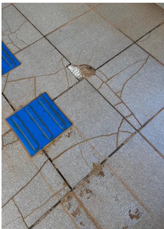
Figura 6 – Fissuras no revestimento cerâmico
