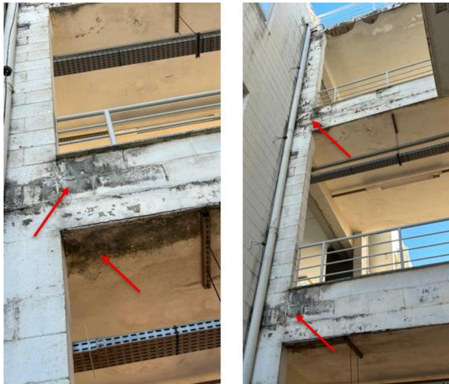
Figura 11 – Manchas de umidade e bolor
