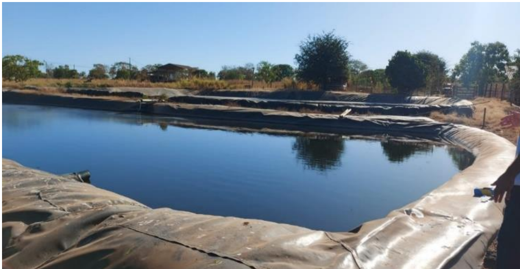
Figura 1 - Lagoa de tratamento do efluente de abate de bovinos.
