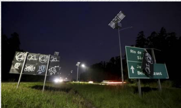
Figura 4: Deterioração e má conservação do Arco Metropolitano.
