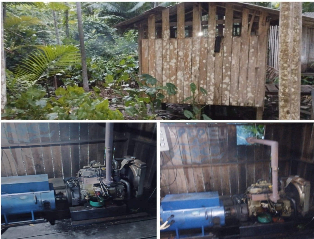
Figura 3: Gerador de energia usado na comunidade Santa Maria do Curuçá
